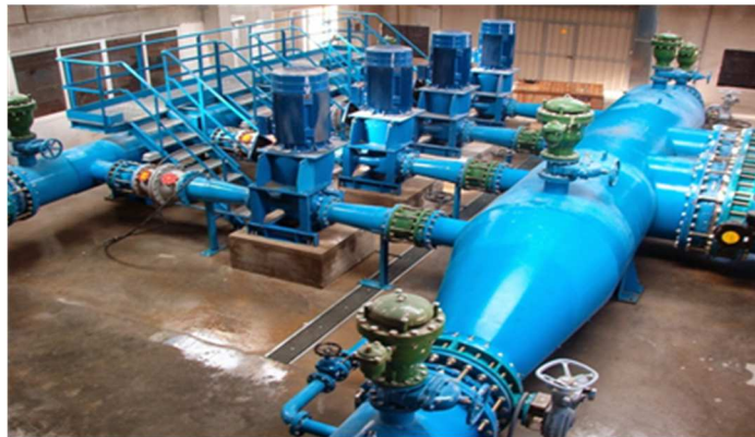
Figura 1. 2: Vista general de una estación de bombeo. Fuente: (Teximco, 2017) Elaborado por: Autor
