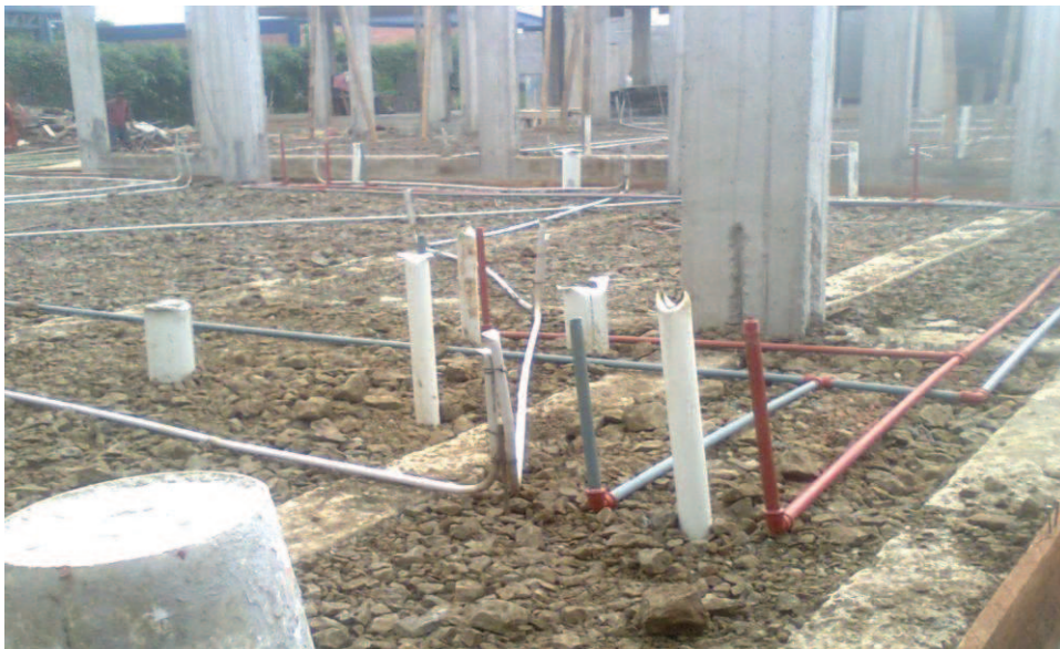
FOTO 24 Instalaciones eléctricas, sanitarias y de agua potable
