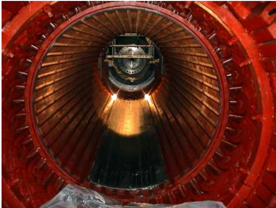
Figura 2. 10: Generador eléctrico Fuente: (Fundación Endesa)
