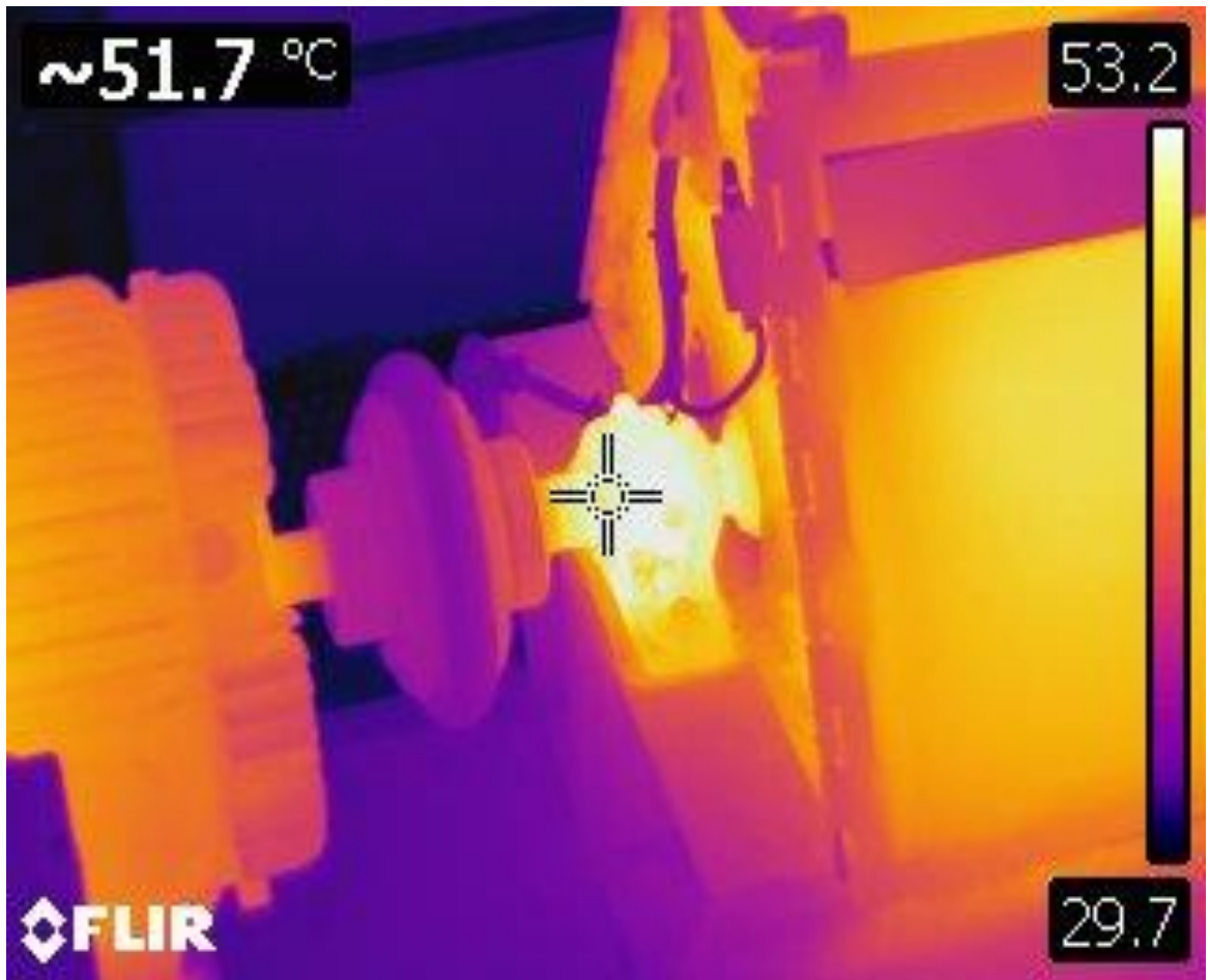
Problemas ocasionados por desalinamiento aumento de temperatura cámara termo gráfica.
