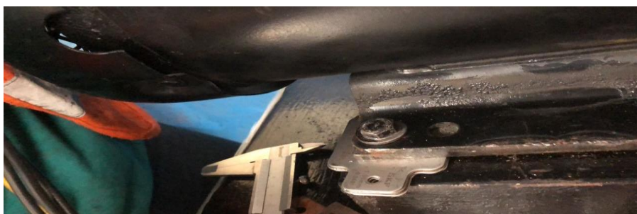
Figura 8. 13 Colocación de chapas calibradas en las patas del motor Elaborado: El autor
