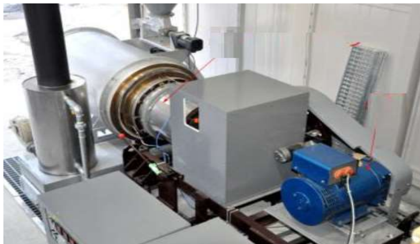
Figura 3. 1 Generador eléctrico y motor adecuado para biogás
