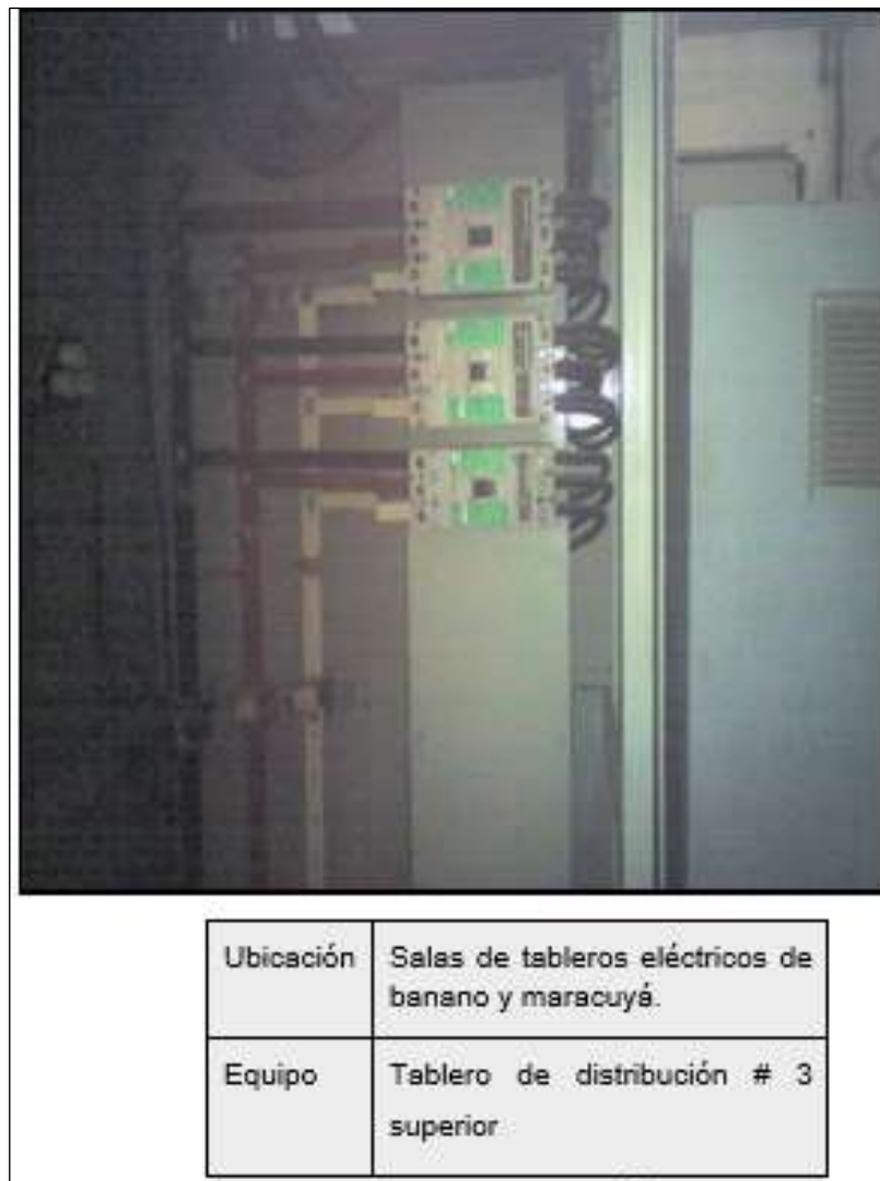
Figura: 5. 10 Tablero de distribución # 3 superior Fuente: El autor
