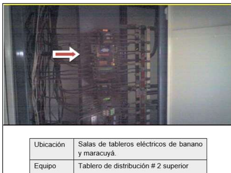
Figura: 5. 6 Tablero de distribución # 2 superior Fuente: Autor
