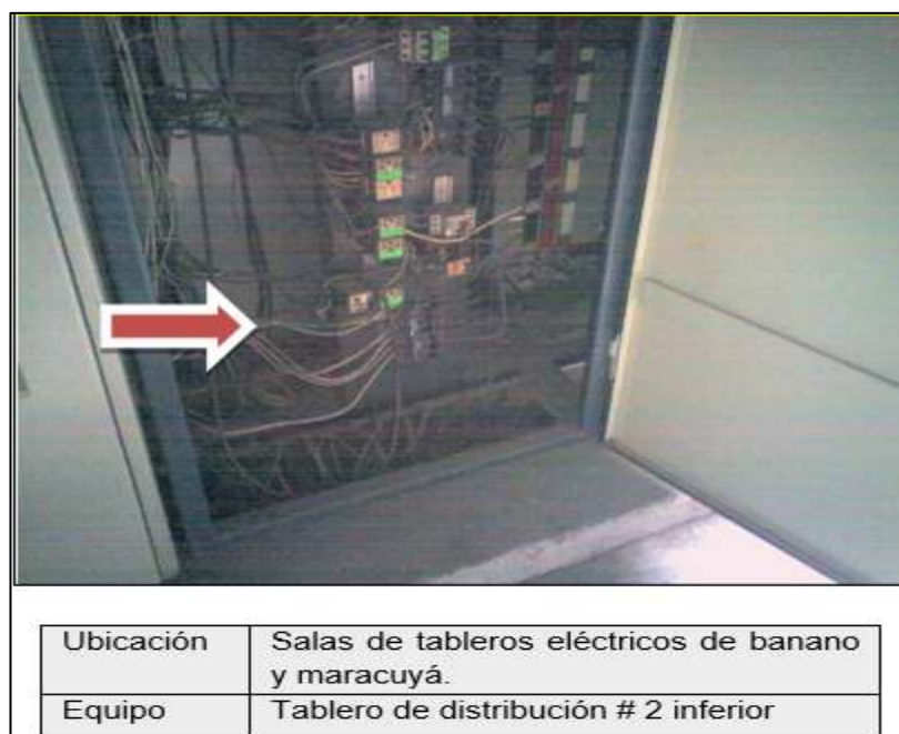
Figura: 5. 8 Tablero de distribución # 2 inferior Fuente: Autor
