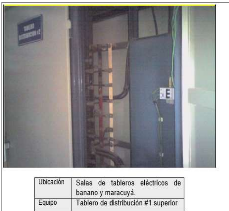
Figura 5. 2 Tablero de distribución #1 superior
