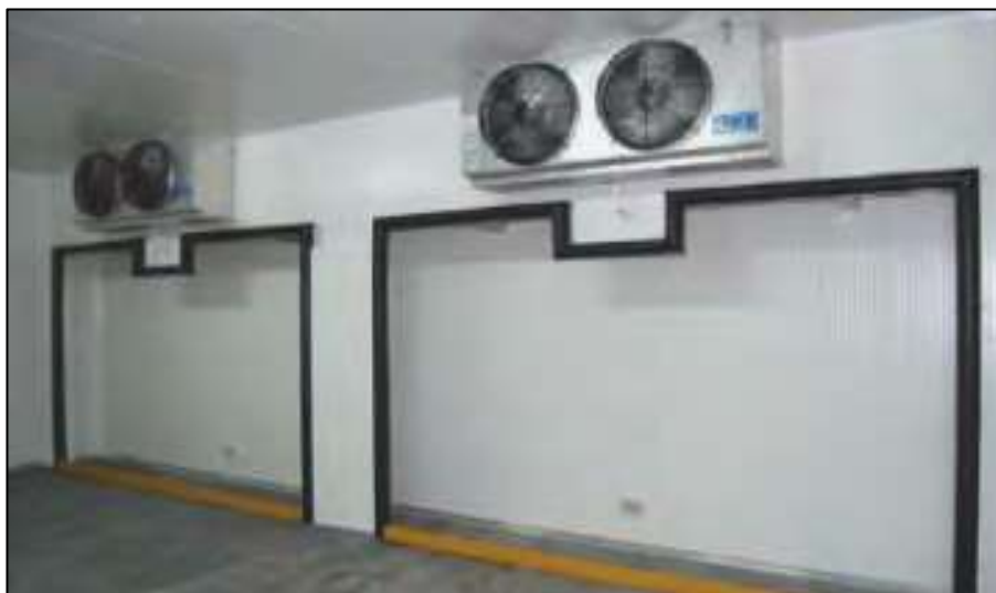
Figura: 4. 1 Interior de una cámara de maduración Elaborado: Autor
