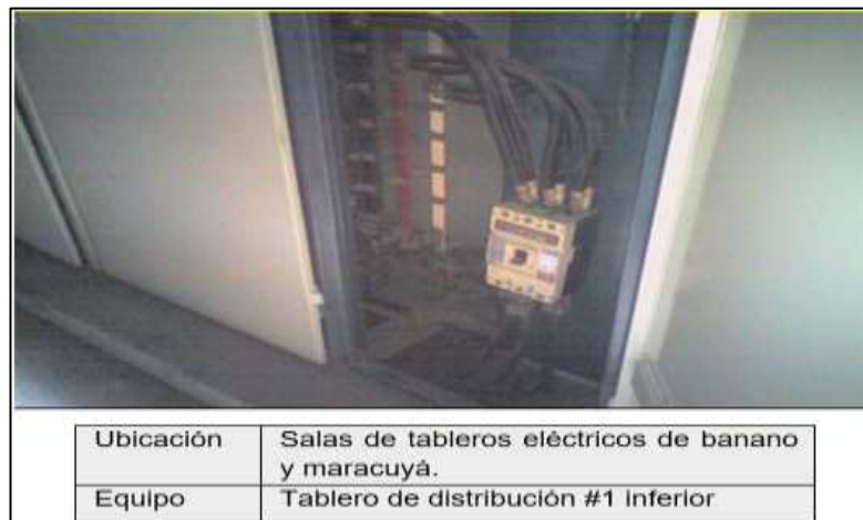
Figura: 5. 4 Tablero de distribución # 1 inferior Fuente: Autor
