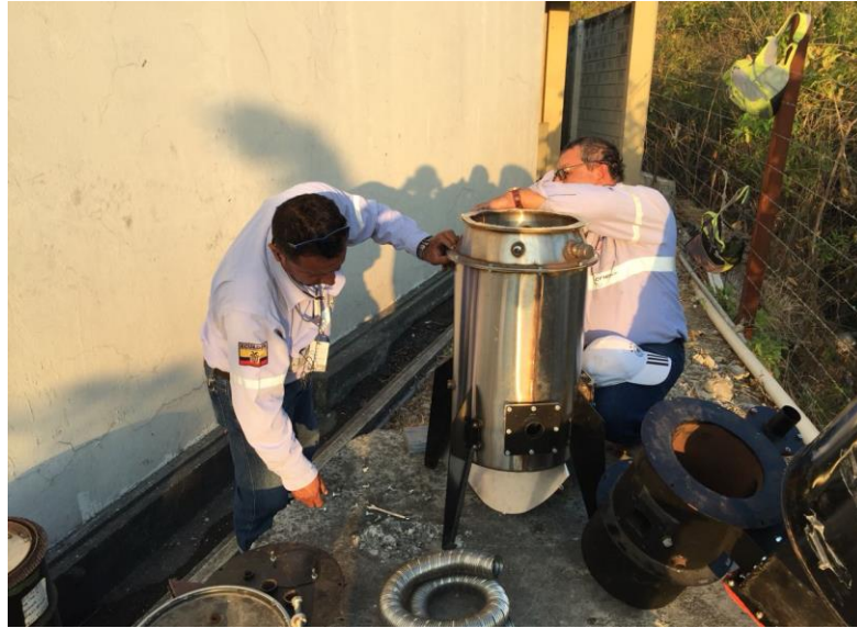
Figura 3. 16 Reactor preparado para conexión con otros componentes.
