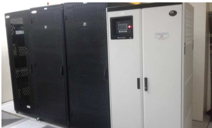
Figura 3. 5: Data Center. Elaborada por: Autor.
