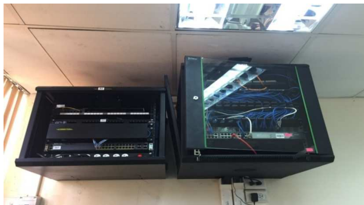
Figura 3. 2: Sala de cómputo Elaborado por: Autor.
