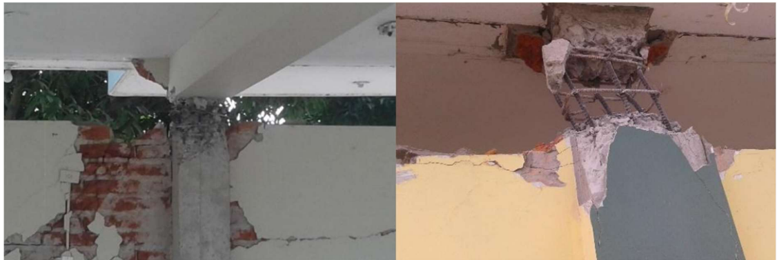
Ilustración 24. Falla por comportamiento de columna corta
