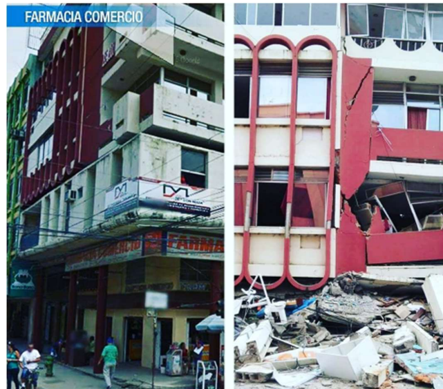
Ilustración 21. Falla del primer nivel de la estructura
