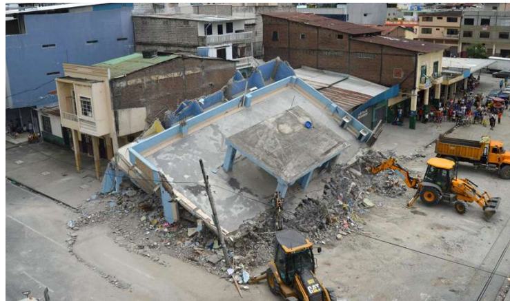
Ilustración 20. Falla por piso débil. Edificio de la esquina Ayacucho y García Moreno en Guayaquil.
