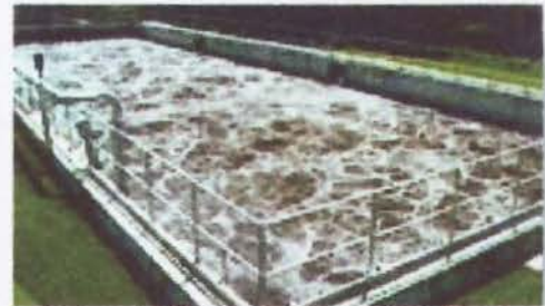
(Foto 27). PISCINA DE LODOS ACTIVADOS.
