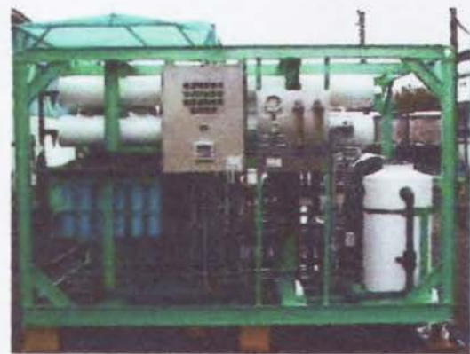
(Foto 34). PROCESO DE OSMOSIS INVERSA
