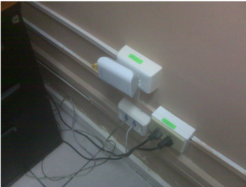
Figura A3.2: Adaptador PLC Estación de Trabajo #5
