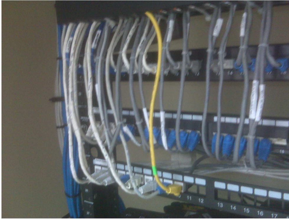
Figura A3.3: Conexión en el patch Panel del Bastidor de equipos
