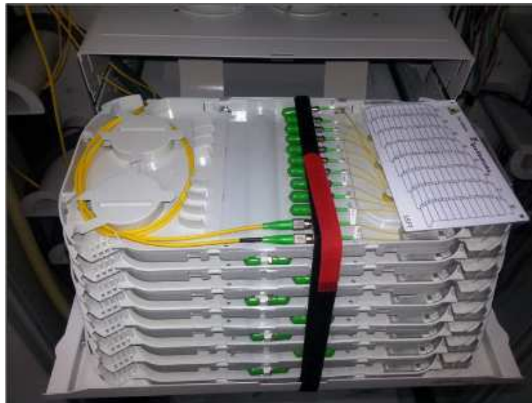
Figura 2. 11: Divisor pasivo, óptico con una proporción de 1:32. Fuente: (Jaya Riofrío, 2016)
