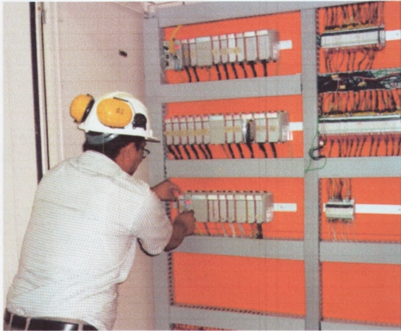
Figura. 2-1. Rutina general de Mantenimiento en tablero eléctrico.
