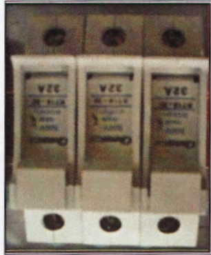
Figura 4.26: Caja portafusibles, contiene las protecciones para inversor, batería y dinamó. (Fotografía tomada durante el desarrollo de pruebas eléctricas).
