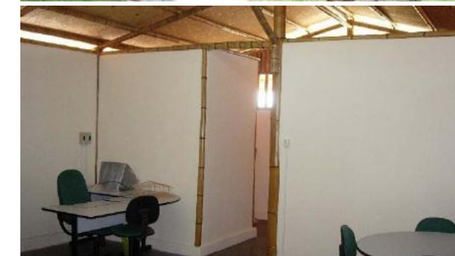
Imagen 202: Imágenes de paredes de caña guadúa revestidas con mortero de cemento. (Núñez., 2008).
