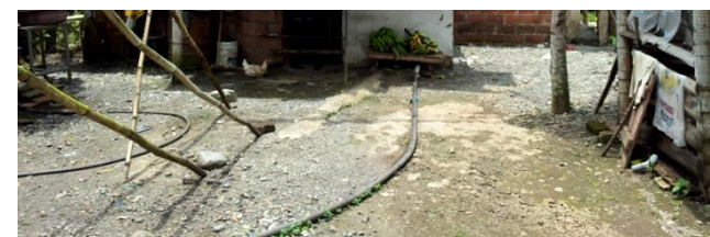
Imagen 65: Manguera superficial conduce las aguas servidas del baño al pozo séptico.
