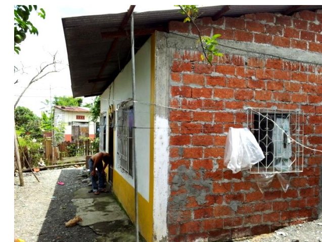
Imagen 35: Imagen de la parte frontal de la vivienda con los materiales que la componen y sus acabados.
