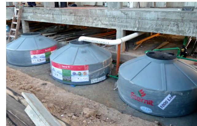
Imagen 167: Tanques de almacenamiento de agua lluvia. (Google imágenes, 2012)
