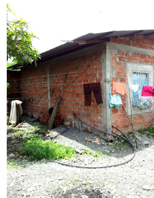
Imagen 36: Imagen de la parte posterior de la vivienda con los materiales que la componen y sus acabados.
