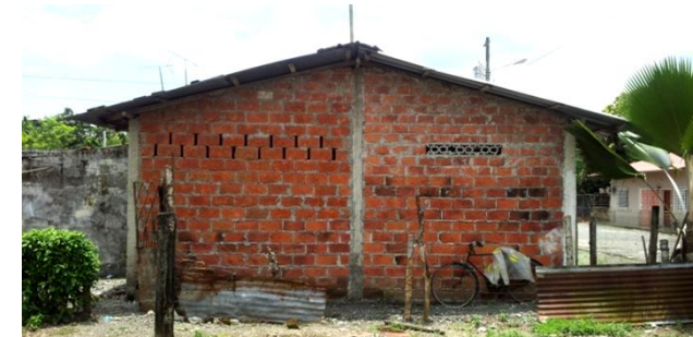
Imagen 73: Fachada lateral Este. Estructura de hormigón armado no presenta vigas superiores de amarre.
