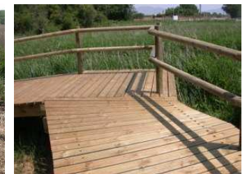
Foto No. 15: Uniones madera Fotografía: SolucioNAT
