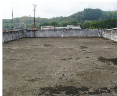
I09. Losa de cubierta del edificio sin protección.
