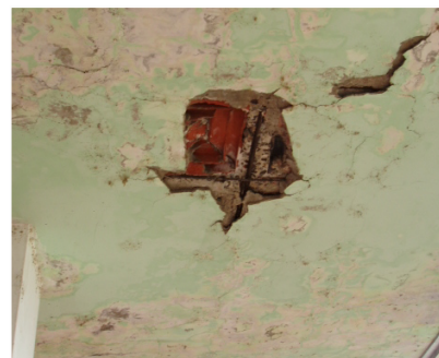
I10. Corrosión de los elementos metálicos de la losa.
