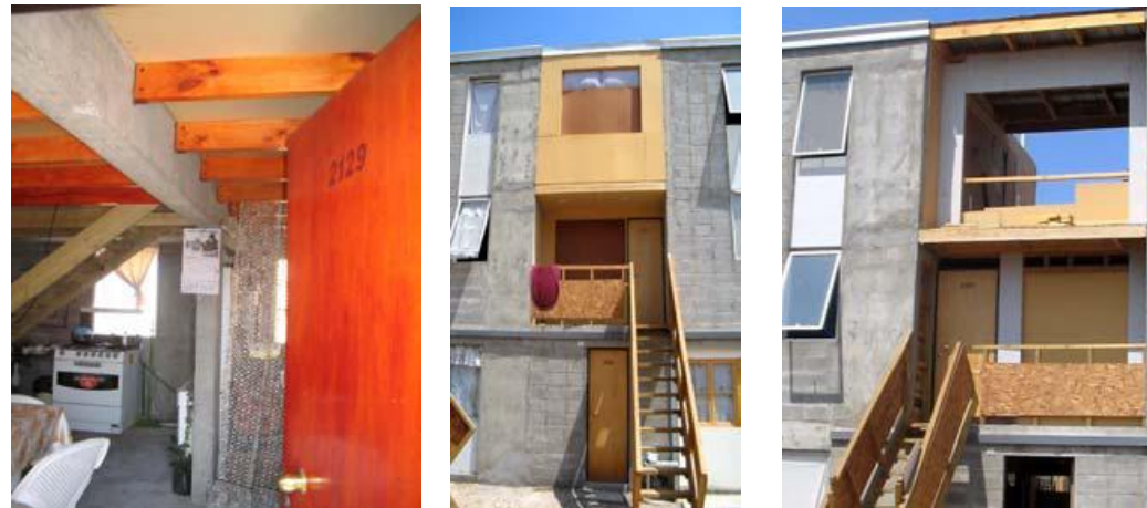
Imagen 18. Derecha estructura entrepiso ampliado con madera, centro y extremos, ampliaciones proyectadas. Fuente: Registro alumnos Arquitectura UCN, abril [2005]. Aunque las ampliaciones realizadas con materiales livianos y confinados entre la estructura más masiva de albañilería armada, esto reduce el riesgo de propagación de incendio.
