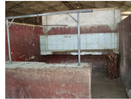
IMAGEN 3: Algunos puestos de venta de cárnicos se encuentran abandonados por falta de condiciones adecuadas para su funcionamiento.
