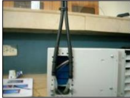
Figura 4.24: Ingreso de 2 cables a ODF (b)
