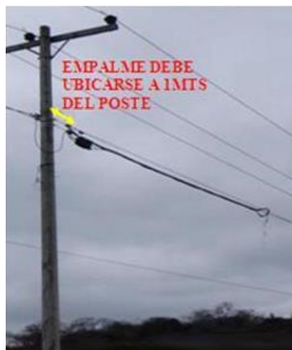
Figura 3. 9: Ejemplo de empalme en tendido aéreo de fibra Fuente: (Morales & Posligua, 2010)
