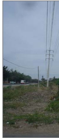
Línea de alta tensión que pasa sobre la Vía principal
