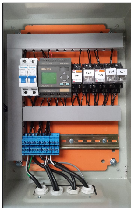
Figura 7. 2: Tablero de control Elaborado por: Autor
