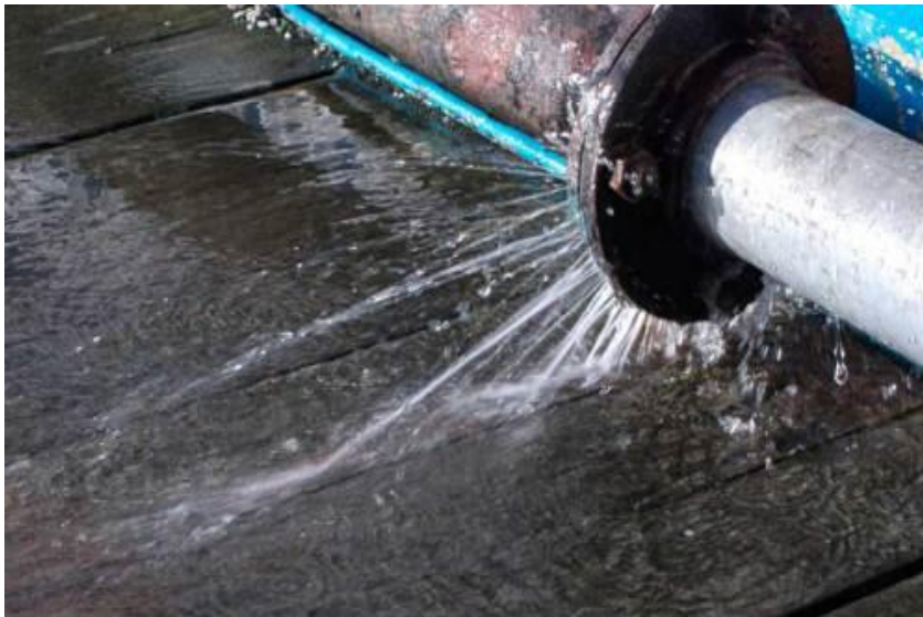
Figura 2.21: Fuga en unión de dos tuberías. Fuente: (Hidro Fugas, 2017)
