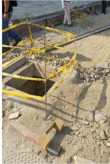
Figura 3.11: Entrada de los cables de fibra de 24 hilos que proviene de los pedestales Elaborado por: Autor
