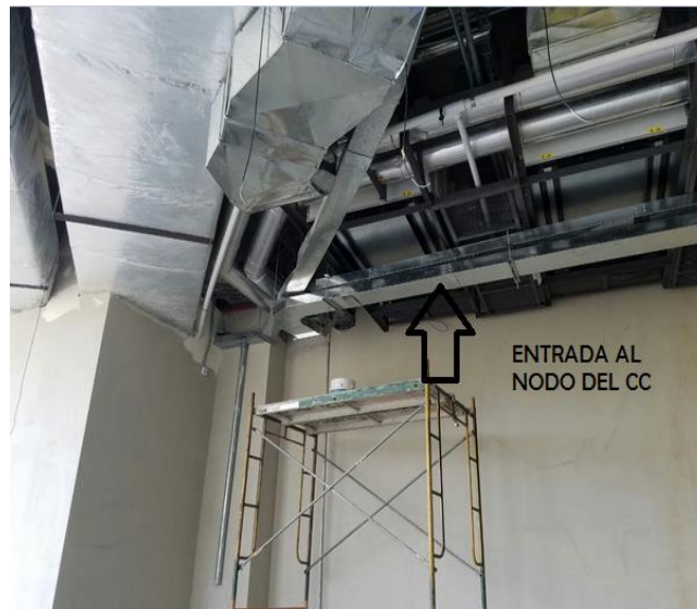
Figura 3.13: Recorrido de la fibra por las canaletas para alimentar al nodo Elaborado por: Autor
