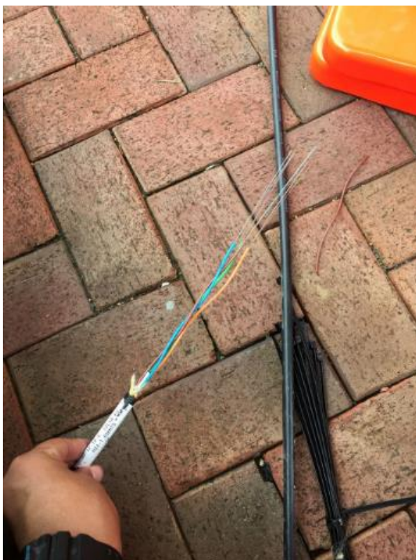
Figura 3.1: Cable de fibra óptica monomodo de 24 hilos Elaborado por: Autor
