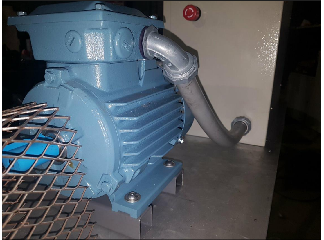
Anexo 41. Vista de la acometida del motor. Elaborado por: Autor
