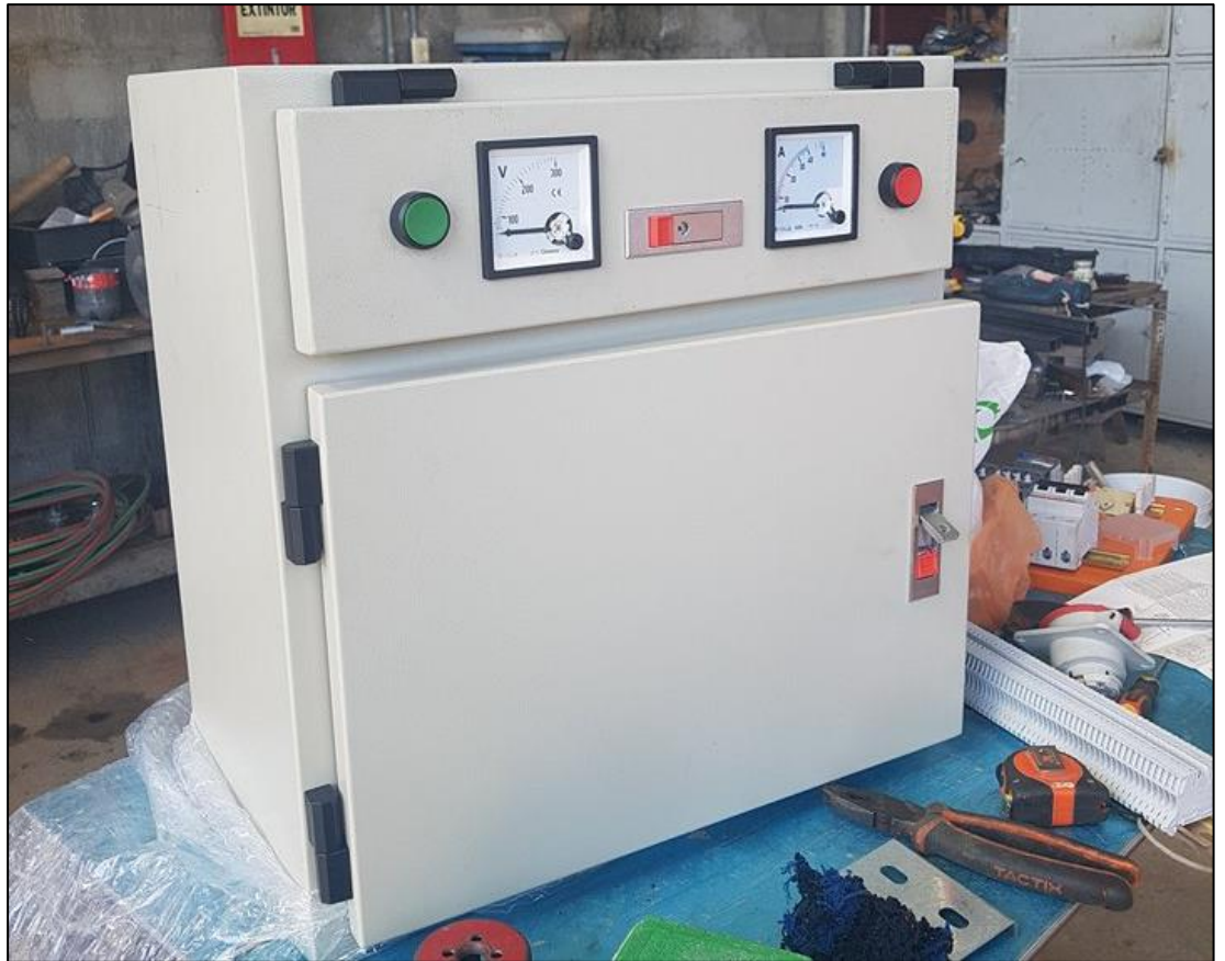
Anexo 9. Culminación del montaje de los equipos de medición Elaborado por: Autor
