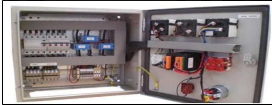
Figura 2.2: Tablero de control Fuente: (Macías & Gonzales, 2013)
