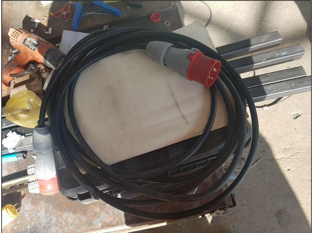
Anexo 19. Conexión de enchufes para la extensión de alimentación al tablero Elaborado por: Autor
