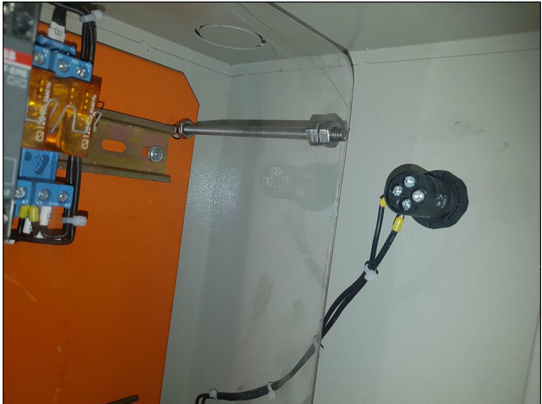
Anexo 29. Conexión del botón de paro de emergencia Elaborado por: Autor
