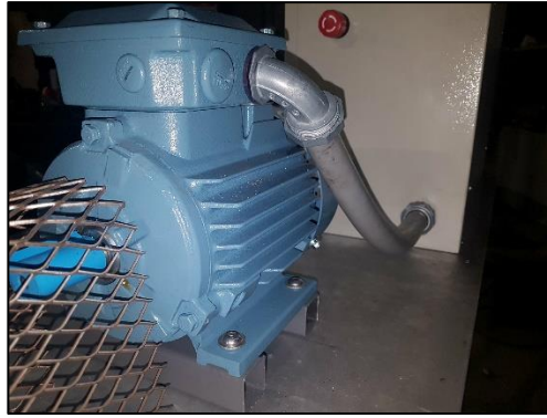
Figura 6. 1: Acometida del motor Elaborado por: Autor
