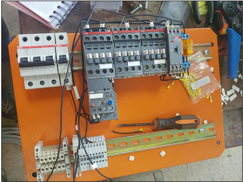
Anexo 17. Cableado de los elementos de control y fuerza del tablero Elaborado por: Autor
