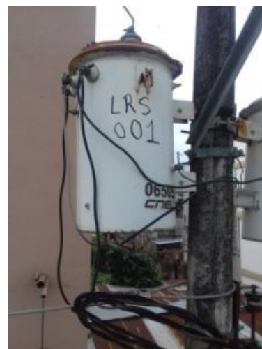
FOTO DEL TRANSFORMADOR
