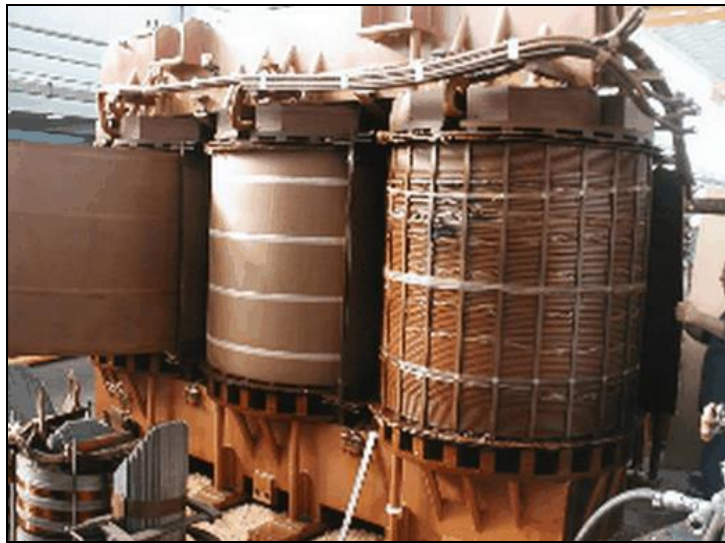
Figura. 2.13 Sistema de aislamiento del transformador Fuente: (Granero, 2015)
