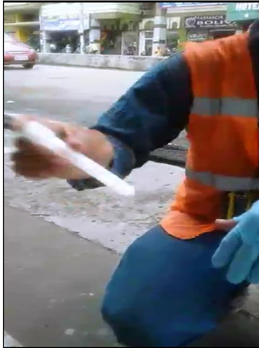
Figura. 8.14 Ruptura de la ampolla transparente del tubo Fuente: ("CNEL EP LRS", 2017)
