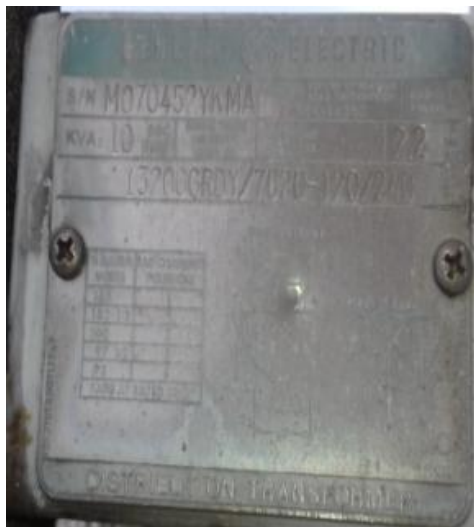
FOTO PLACA TRANSFORMADOR
