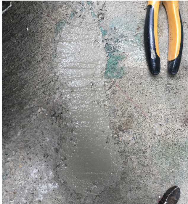
Figura 41: Orificios rellenos con mortero y terminados al mismo nivel que el resto de la superficie de las losetas
