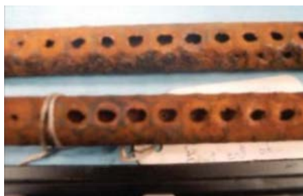
Figura 4: Corrosión por erosión
