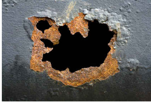
Figura 6: Corrosión por picadura
