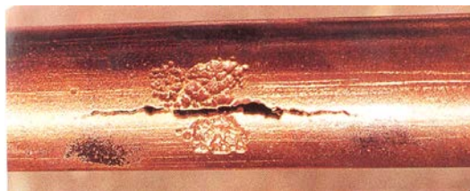
Figura 11: Corrosión por fatiga
