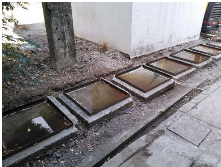
Figura 21: Losetas saturadas con agua
