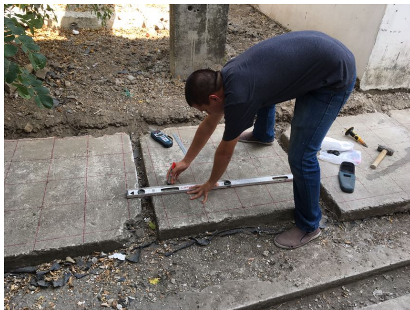
Figura 19: Realizando dibujo en la superficie de las losetas con ayuda del detector de armaduras para conocer la ubicación de la misma
