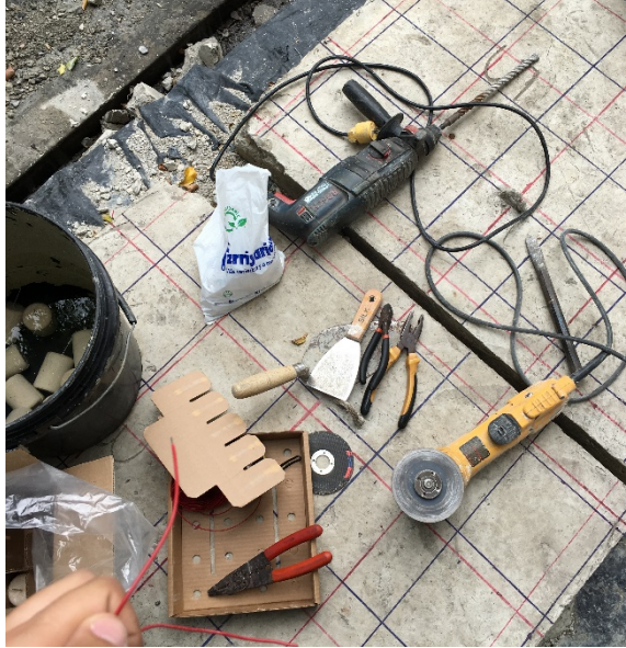
Figura 33: Equipos y herramientas utilizados para la instalación de los ánodos. Ánodos sumergidos en agua
