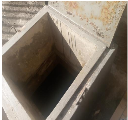
Fotografía 26. Cisterna del Bloque S1.
