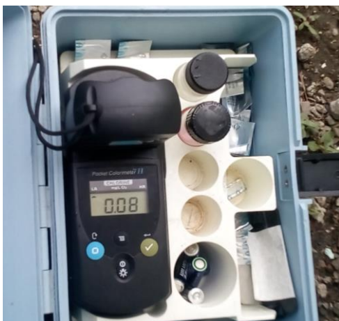
Fotografía 37. Cantidad de Cloro que ingresa a la cisterna del Bloque 1.
