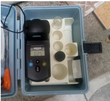
Fotografía 27. Cantidad de Cloro que ingresa a la Cisterna del Bloque S1
