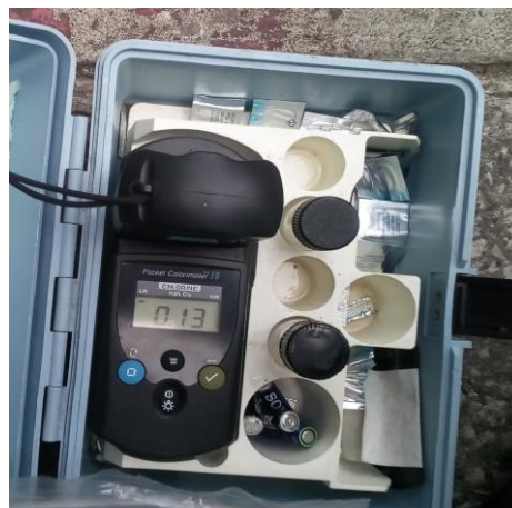
Fotografía 40. Cantidad de Cloro que ingresa a la Cisterna del Bloque 2.
