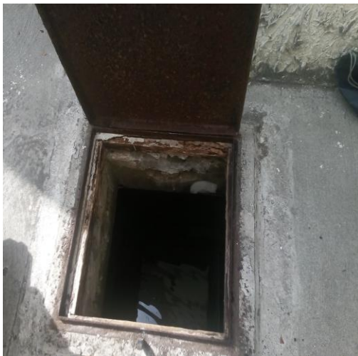
Fotografía 3. Estado de la Cisterna del Bloque C7.
