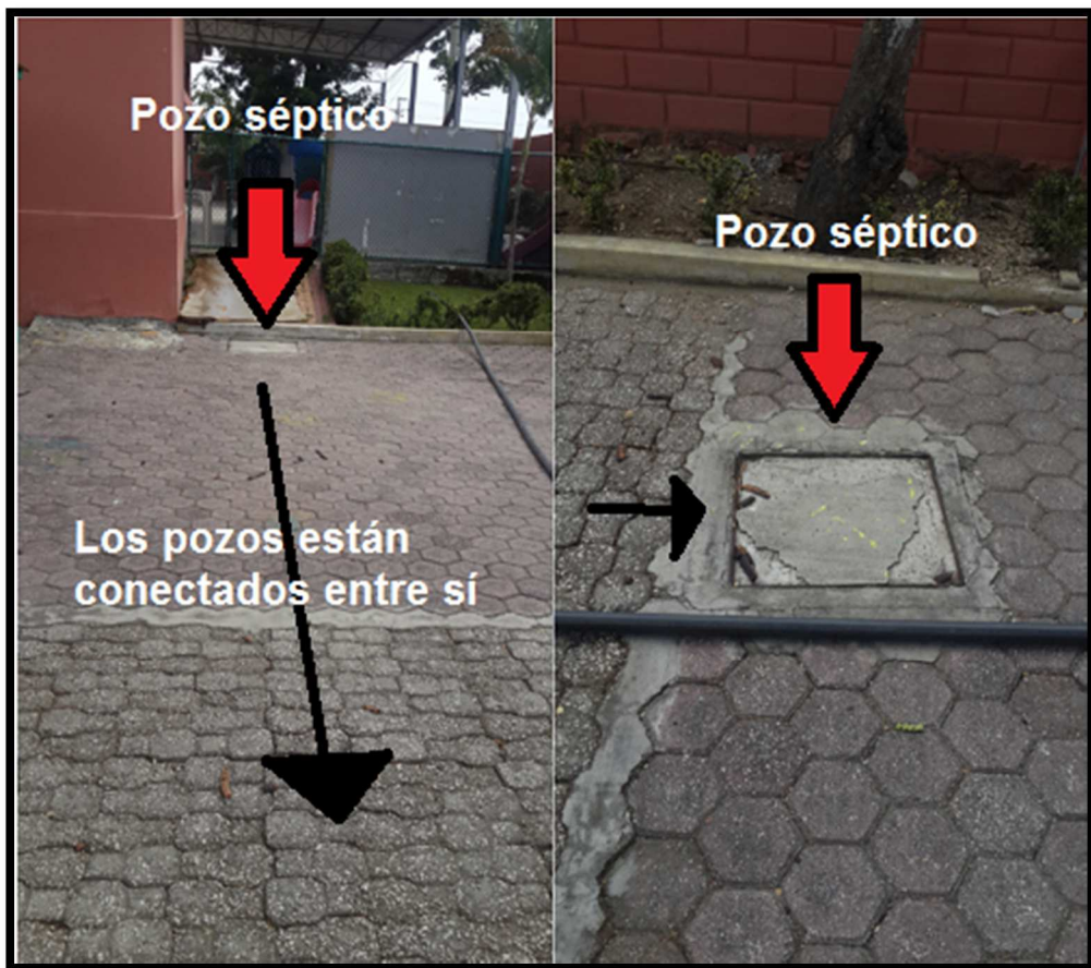
Ilustración 23. Pozo séptico ubicado en la Unidad Educativa "Santiago Mayor" (cancha de básquet)
