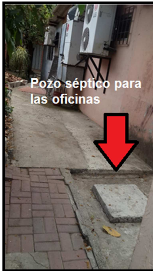
Ilustración 24. Pozo séptico ubicado en la Unidad Educativa "Santiago Mayor" (oficinas de secretaria)
