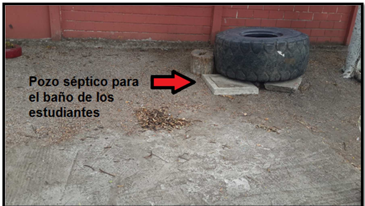
Ilustración 25. Pozo séptico ubicado en la Unidad Educativa "Santiago Mayor" (Baños estudiantiles)
