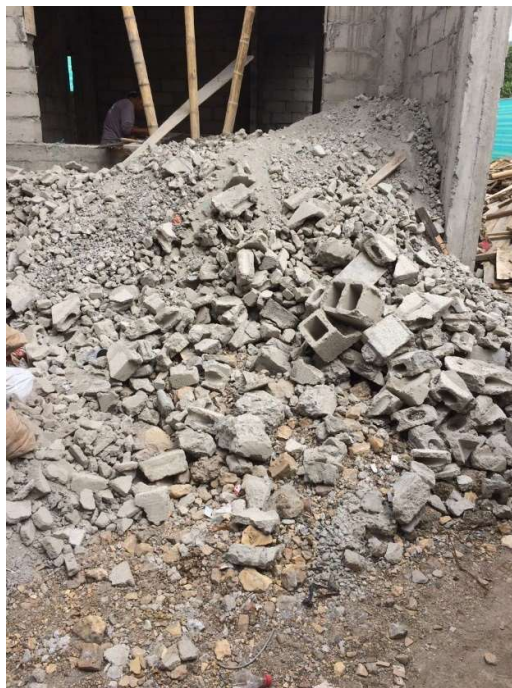
Ilustración 50: Residuos de bloques de hormigón en obra
