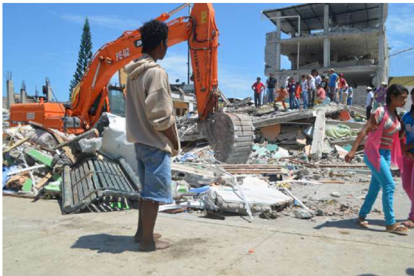
Ilustración 7: Maquinaria realizando limpieza de escombros, luego del terremoto de abril del 2016 en Ecuador
