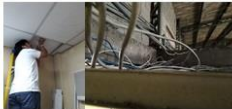
Figura 30. Techo falso de Sala de equipamiento.
